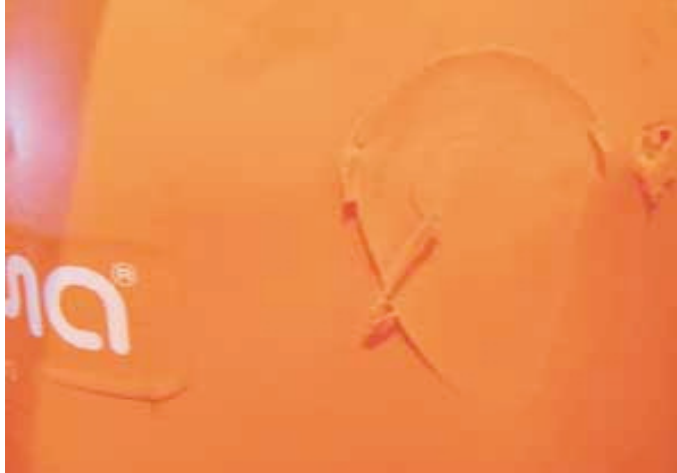
Figure 3a Domage superficiel par la chaleur (niveau 2) – réparable
