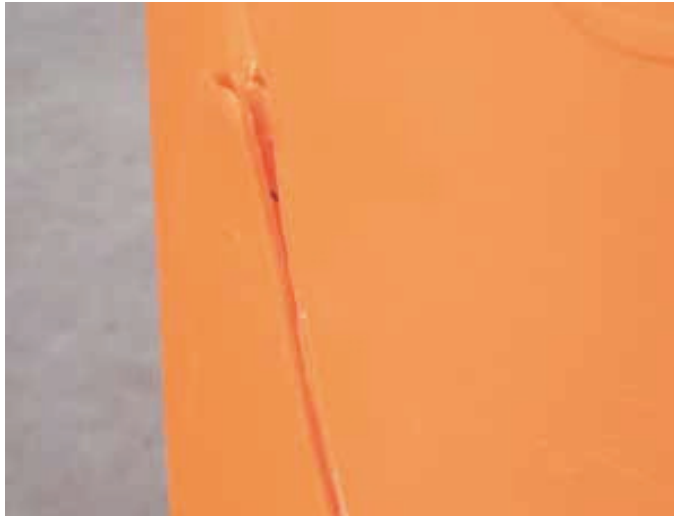
Figure 7a Coupures et goujures (niveau 2) – réparable
